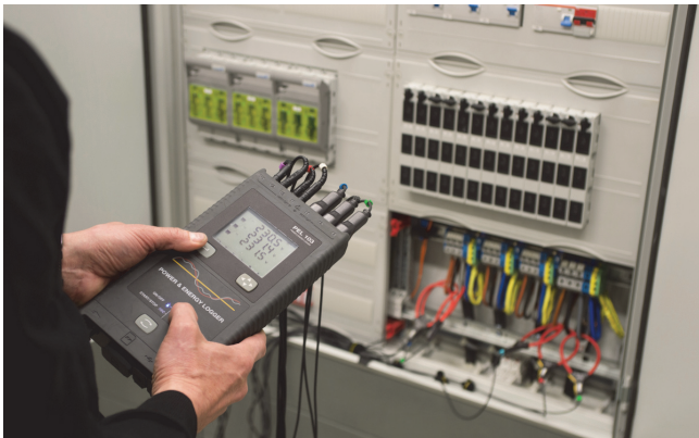
Mobile elektrische Energiemessung für die Optimierung von Betriebsstrategien. Bild: Bernd Müller / Fraunhofer
