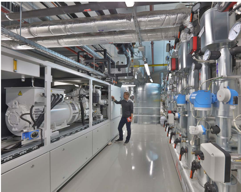
Blockheizkraftwerk und Warmwasserspeicher im Keller des IISB: Die Kraft-Wärme-Kopplungs-Anlage wurde im Rahmen des Erweiterungsbaus B in die Infrastruktur des Instituts integriert. Dort wird sie sowohl zur Wärme- und Stromversorgung als auch als Forschungsanlage genutzt. Foto: Kurt Fuchs / IISB
